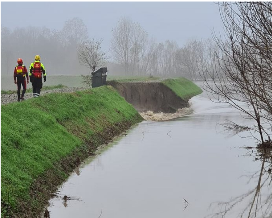
Figura 6. La rotta come si è presentata ai Vigili del fuoco giunti sul posto verso le 8:30 del mattino
