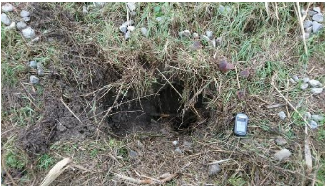
Figura 121 Perforazione rinvenuta su scarpata dell'argine destro in prossimità dello stante 33 lato campagna.
