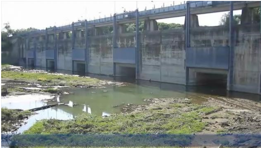
Figura 32. Il sistema delle 5 paratoie del manufatto di moderazione della Cassa di espansione di S. Anna, visto da monte, in condizioni di portata ordinaria (Immagine Gazzetta di Modena)
