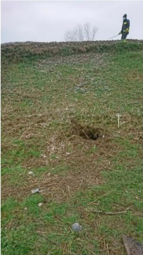
Figura 122. Perforazione rinvenuta sulla scarpata dell'argine destro in prossimità dello stante 33 lato campagna.
