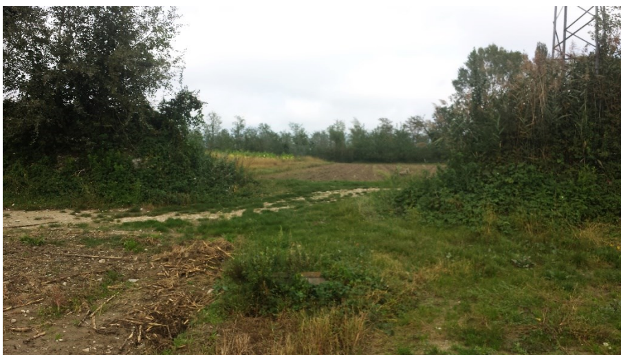
Figura 3. Esempio negativo dell'arginatura maestra del fiume Tevere (2014) a valle della Diga di Montedoglio (AR), completamente colonizzata da vegetazione arbustiva e anche di alto fusto, all'interno della quale è presente la struttura di fondazione del traliccio
