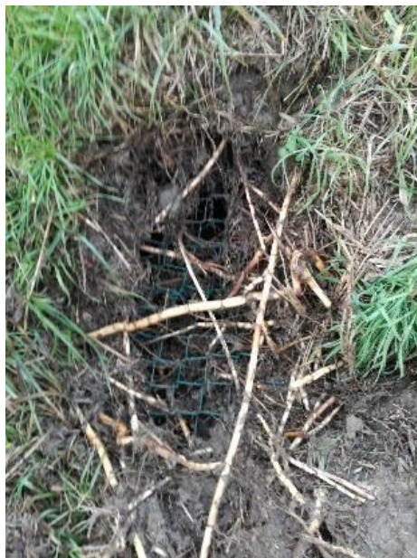
Figura 119. Imboccatura di foro posto sulla scarpata dell'argine sinistro a circa 20 m a monte dello stante 27 lato fiume.
