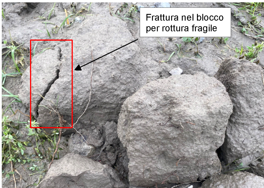
Figura 71 Blocchi di rilevato arginale (si noti la tenenza alla rottura fragile) (foto di Paolo Simonini del 29/12/2020).
