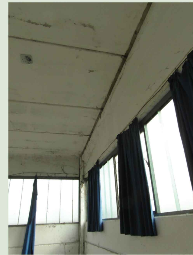
Vista interna distacco dovuto alla rotazione dei pilastri
