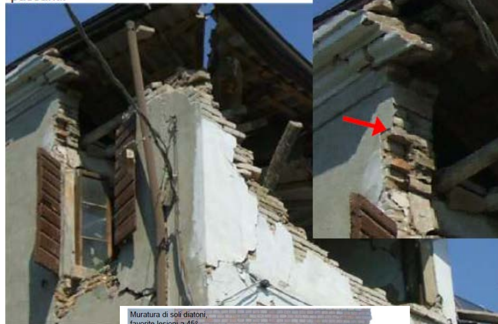
Muratura in mattoni a due teste. Le fodere interna ed esterna sono collegate da diatoni passanti.
