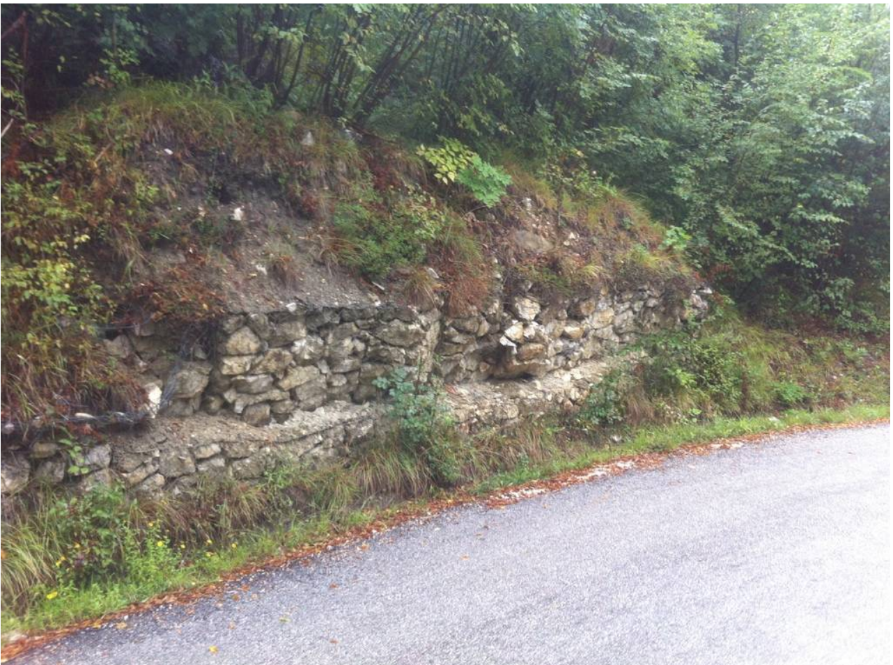
Piede della frana sopra il tornante: si notino i gabbioni dislocati e al limite del ribaltamento.
