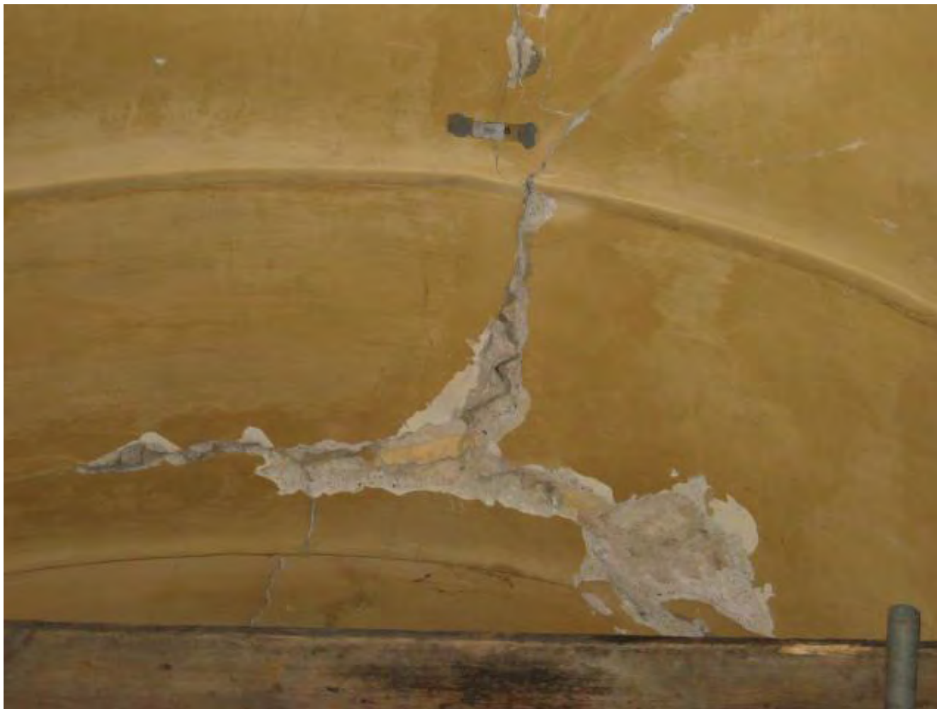
Particolare quadro fessurativo tra volta a crociera e a botte
