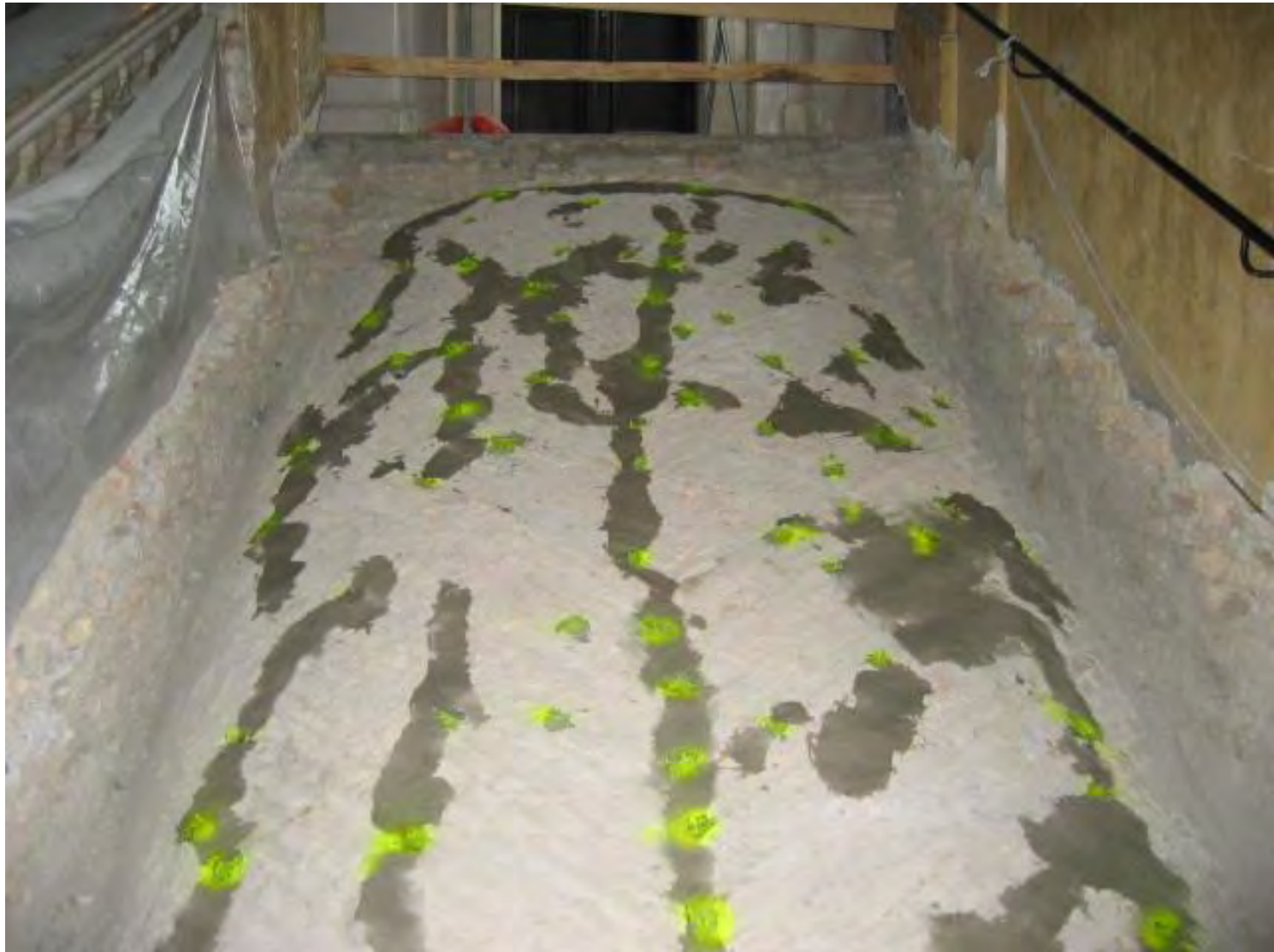
Stuccatura delle fessure con resina epossidica tixotropica Iniezione di resina epossidica bassissima viscosità
