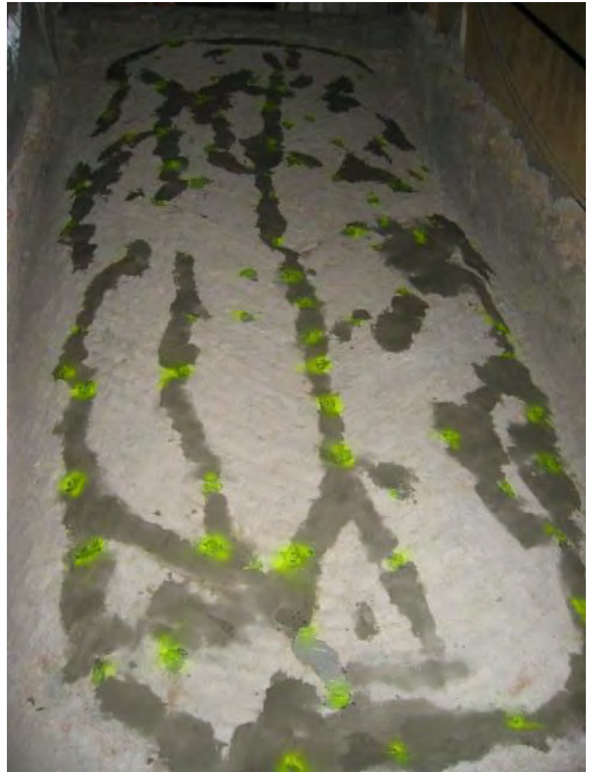
Particolare del quadro fessurativo estradosso delle rampe
