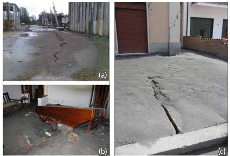
Figura 2. Esempio di danni correlati anche a fenomeni di liquefazione: a) crollo di capannone a Mirabello; b) e c) danni ad edifici residenziali a S. Carlo.
