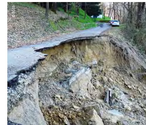
Strada comunale Monzuno Gardelletta (BO). Scivolamento in arenarie che interessa il rilevato stradale.
