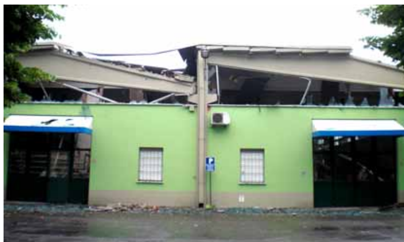
Crollo delle travi di copertura per la perdita dell'appoggio.
