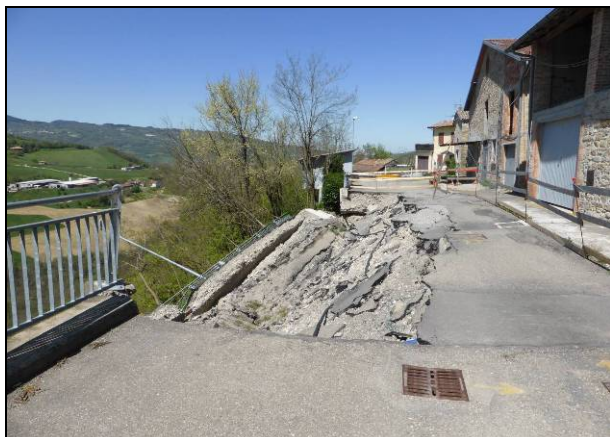
Fig. 31: situazione in seguito all'evento 2014. Compromessi la strada interna al paese e gli edifici prospicienti.
