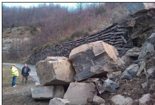
Fig. 59: immagine dei massi caduti sulla SP 25 al piede del movimento franoso (foto gentilmente concessa dalla Provincia di Forlì Cesena).
