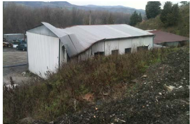
Fig. 28: capannone lesionato dal dissesto che verrà successivamente demolito.
