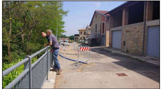
Fig. 32: situazione della frana di Pietta nella primavera 2013. Coinvolta la strada interna al paese, in seguito al cedimento parziale del cordolo su pali a sostegno della strada.
