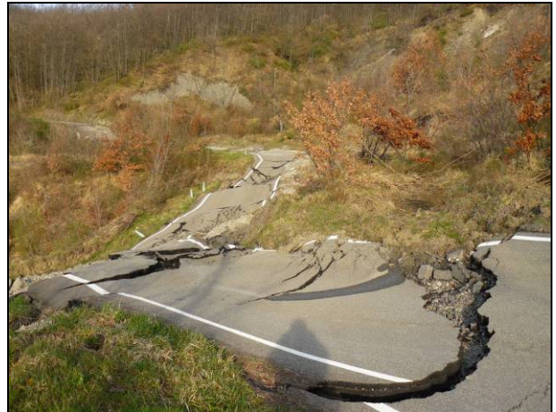
Fig. 24: lesioni alla strada Comunale di Sparvo in loc. Muriccie.
