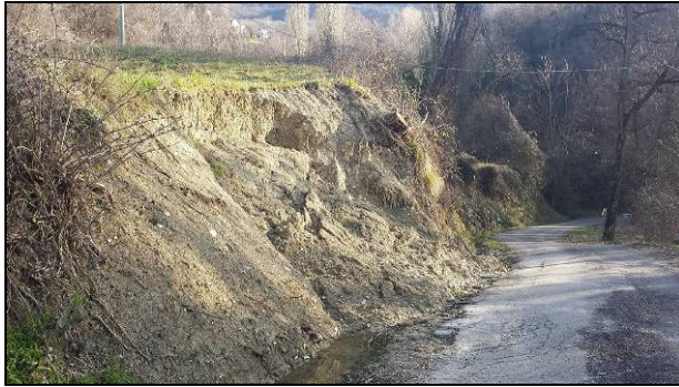
Fig. 7: situazione di tipo b) in Comune di Calestano (PR), senza interruzione stradale (foto gentilmente concessa dal Comune di Calestano).
