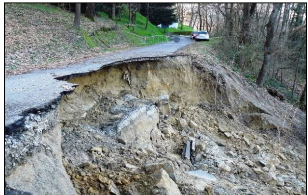
Fig. 10: situazione di tipo c) in Comune di Monzuno (BO), con interruzione totale della viabilità.
