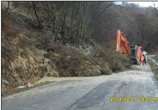
Fig. 8: Situazione di tipo b) in località l'Angela, SP 80 di Scurano, in Comune di Neviano degli Arduini (PR), con interruzione completa (anche se temporanea) del transito per invasione di terra e detrito (foto gentilmente concessa dalla Provincia di Parma).
