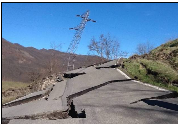
Fig. 44: interruzione stradale prodotta dalla frana di Boceto (foto gentilmente concessa dal STB Affluenti del Po).
