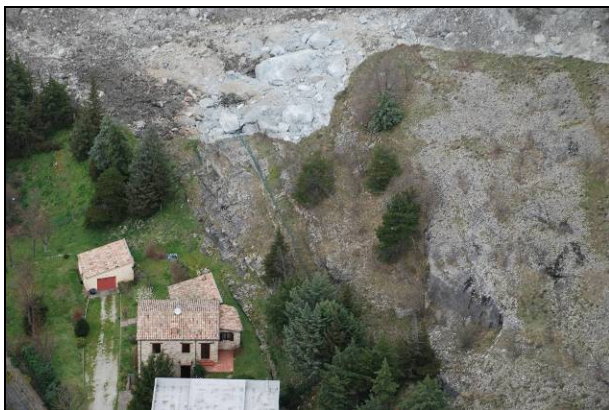
Fig. 51: immagine delle abitazioni più prossime alla parete franata (foto gentilmente concessa dal Servizio Tecnico di Bacino Romagna).
