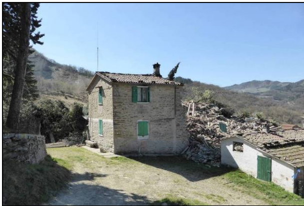
Fig. 55: la casa parzialmente crollata in seguito alla risalita dell'accumulo detritico.
