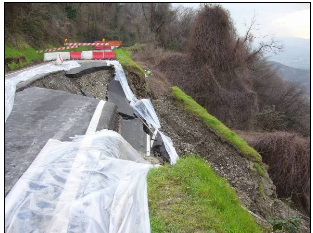
Fig. 11: situazione di tipo c) in Comune di Bologna, via di Sabbiano, con interruzione totale della viabilità. Tratto da http://notiziefabbriani.blogspot.it/ .
