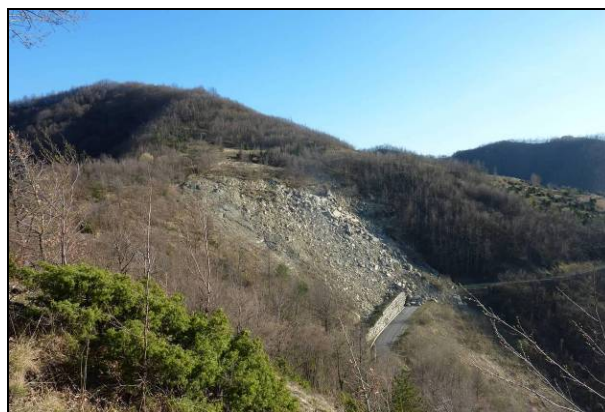
Fig. 60: immagine panoramica della frana sulla SP 25 (foto gentilmente concessa dal Dr. Geol. Alessandro Stefani)
