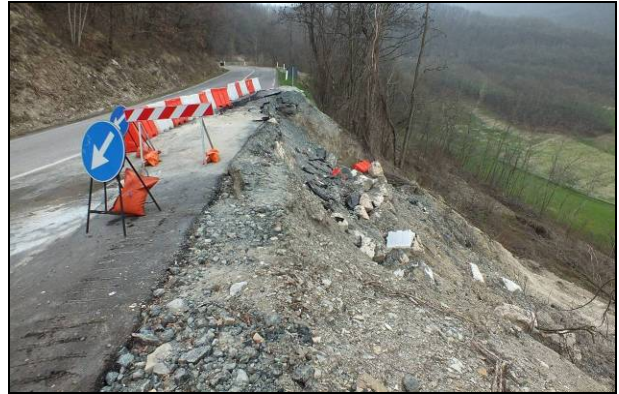
Fig. 9: situazione di tipo c) che interessa la SP 15 Calestano –Berceto (PR), con coinvolgimento parziale della carreggiata. Per sicurezza la strada è rimasta interrotta per circa un mese tra Febbraio e Marzo 2014
