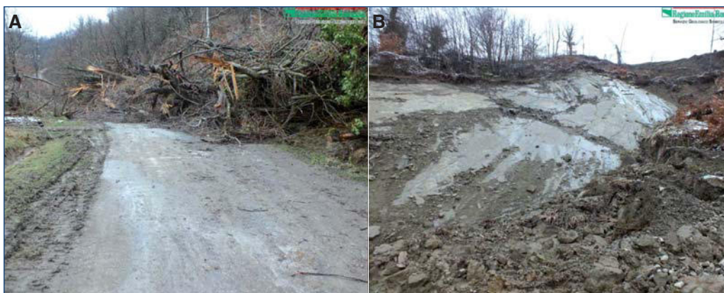
Figura 20. Particolari della frana di Raggiale (Bagno di Romagna, FC). A: accumulo del piede sulla strada comunale; B: particolare della superficie di scorrimento in roccia nella porzione mediana (foto del SGSS).
