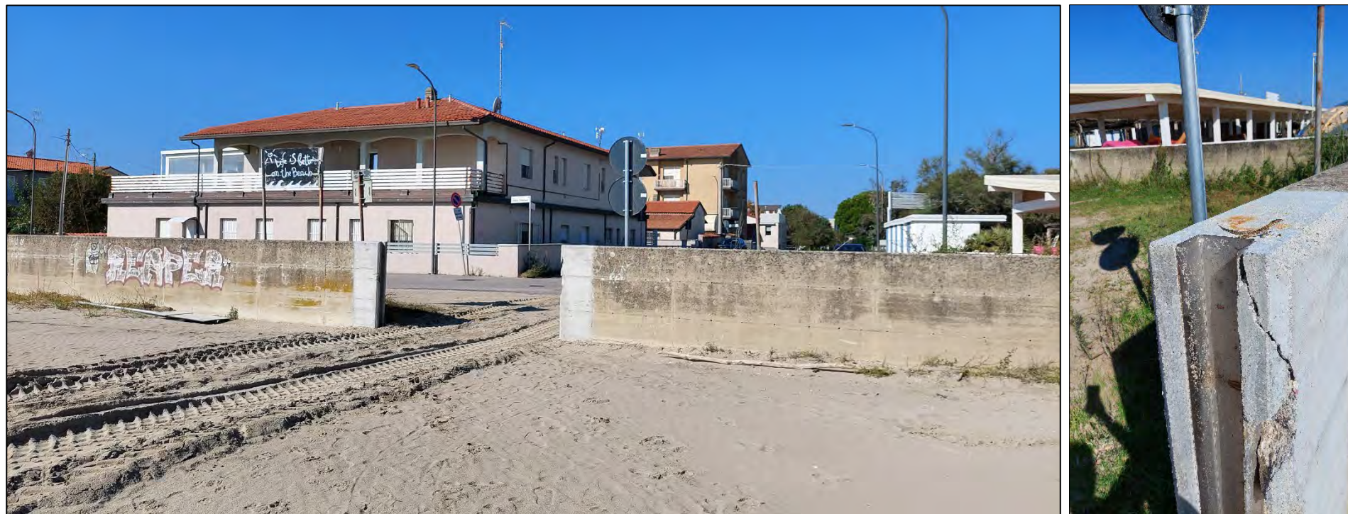
Figura 37: Area 8 dettaglio varchi e muretti. Per quanto sembrano recenti gli interventi di manutenzione degli scassi per l'inserimento delle paratie si denotano fessurazione probabilmente causate dall'impatto con mezzi da lavoro, si raccomandano quindi periodiche verifiche
