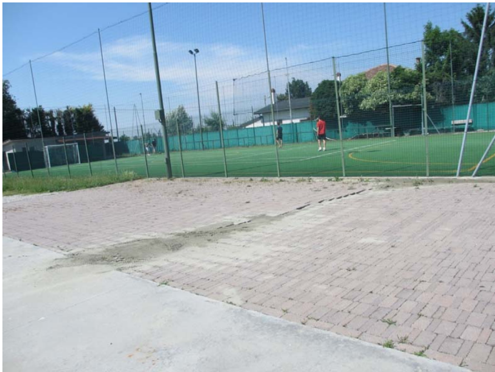
Foto 11.f. – Proseguimento della spaccatura verso il centro abitato di Mirabello, alla sommità dell'argine sinistro (via argine postale)
