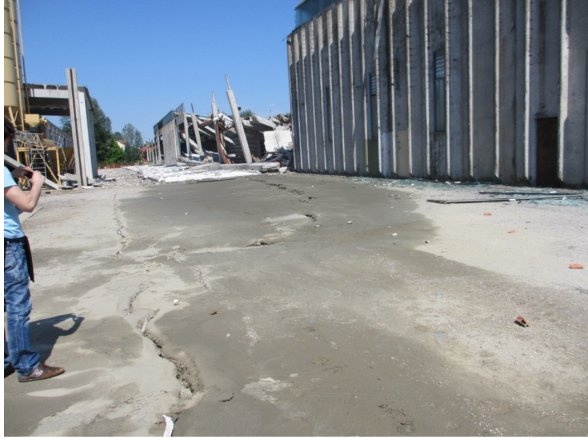
Foto 11.a. – Spaccatura con fuoriuscita di sabbia nel piazzale antistante la serie di capannoni indicata in figura 11, in prossimità del mobilificio Martinelli nella zona industriale di Mirabello (zona sud di Corso Italia, argine sinistro)
