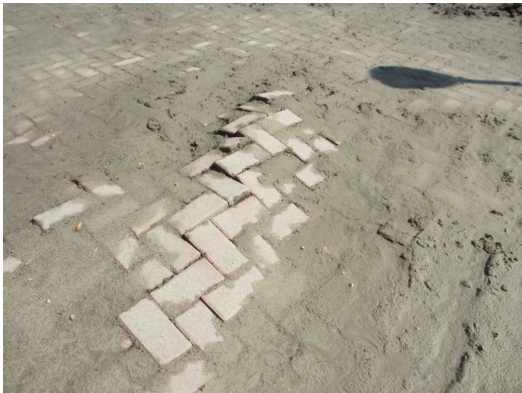
Foto 12.c – Particolare del rigonfiamento della pavimentazione al n.c. 22 di Via Risorgimento, San Carlo
