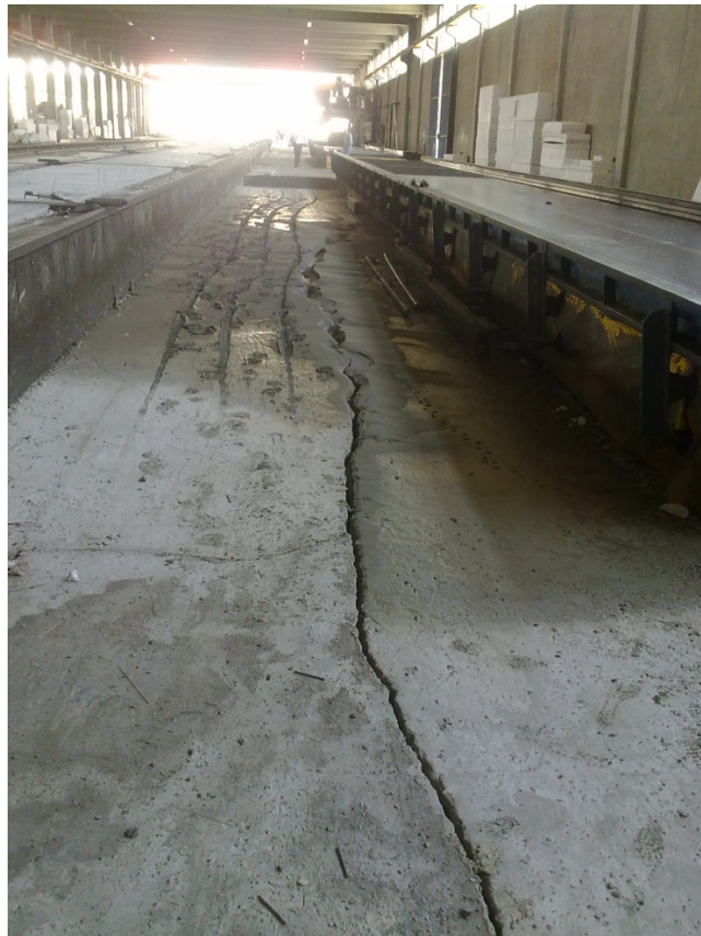
Foto 11.b. – Proseguimento della spaccatura con fuoriuscita di sabbia all'interno dei capannoni adiacenti il mobilificio Martinelli nella zona industriale di Mirabello (Via del Lavoro)
