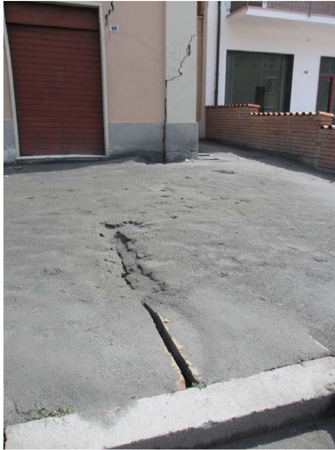
Foto 12e – Edificio in muratura lesionato e fuoriuscita di sabbia in Via Risorgimento, San Carlo
