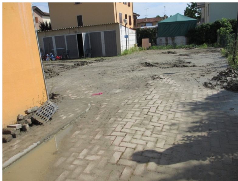
Foto 12.a - Rigonfiamento della pavimentazione e fuoriuscita di sabbia al n.c. 22 di Via Risorgimento, San Carlo
