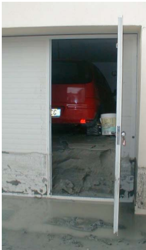
Foto 12m - Intenso rifluimento di sabbia in un garage di Via Morandi a San Carlo.
