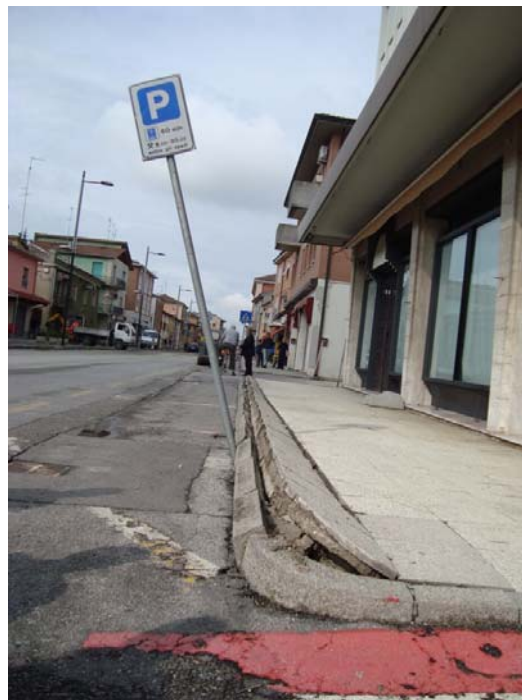
Foto 11.j. – Sollevamento della pavimentazione del marciapiede di Corso Italia (sud della Chiesa) lato destro in prossimità del civico 431
