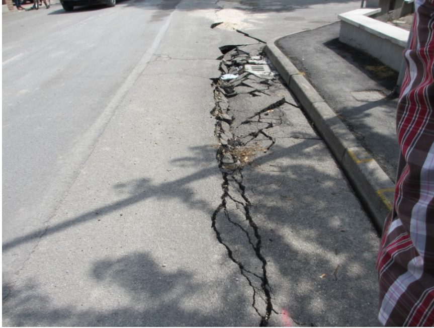
Foto 12i - Spaccature e cedimenti laterali dovuti a liquefazione lungo Viale Gramsci, a San Carlo.
