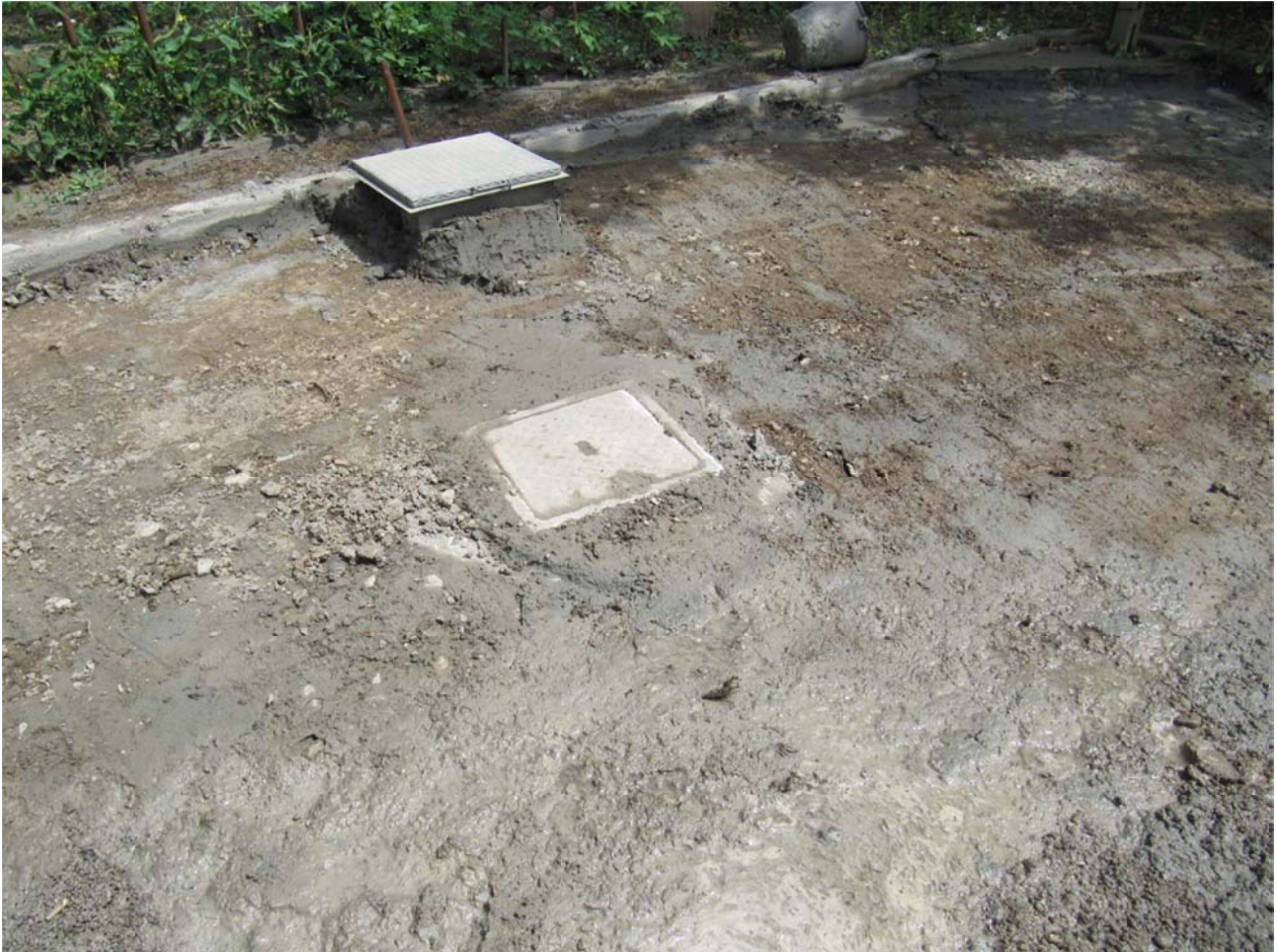
San felice sul Panaro, 20.05.2012, Via Perossaro Vecchia
