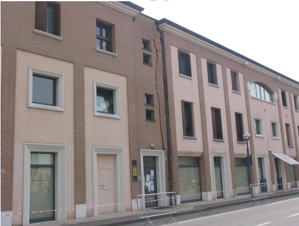
Danni a Cavezzo
