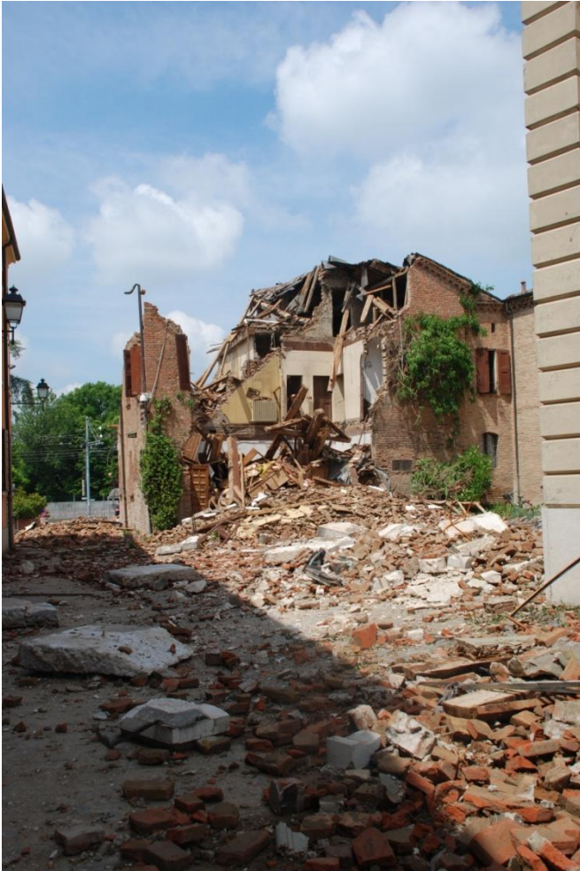
Crollo totale nel centro storico di San Felice sul Panaro
