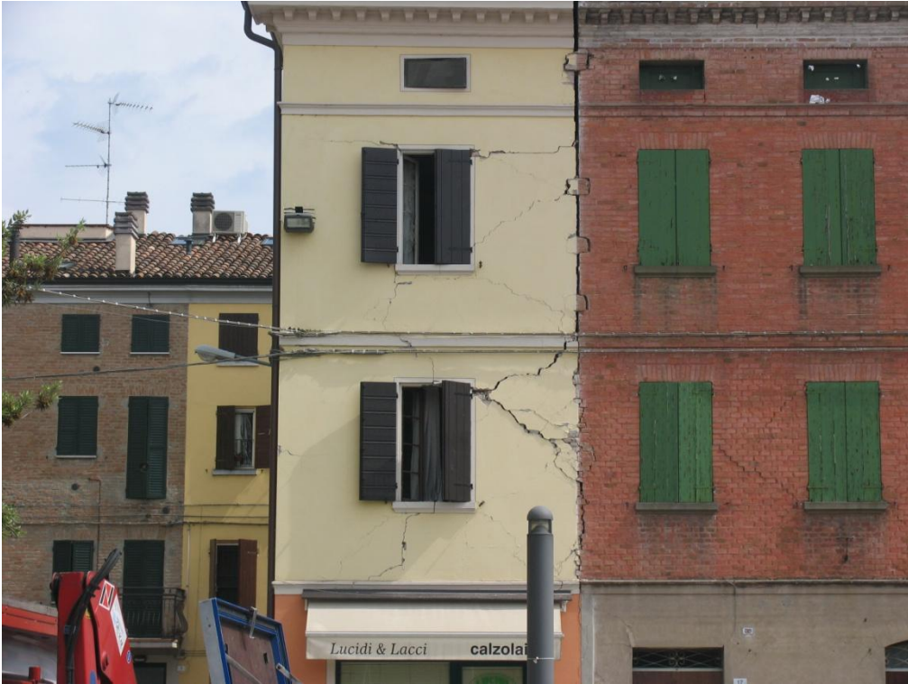
Danni a Cavezzo
