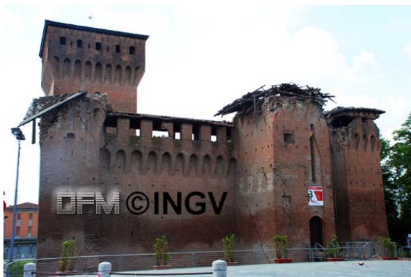
Foto 5. San Felice sul Panaro. Gravi danni subiti da edifici monumentali
