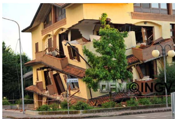
Foto 2. Rovereto sulla Secchia. Danno di grado 5 in edificio in muratura tipo C
