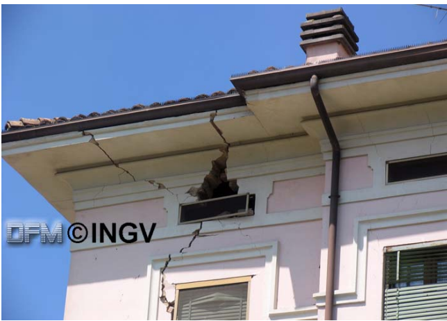
Foto 3. Reggiolo. Crepe larghe e profonde. Danno di grado 3 in edificio di tipo B
