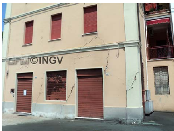
Foto 9. San Carlo. Crepe larghe e profonde in edificio di tipo B. In basso si notano effetti di liquefazione
