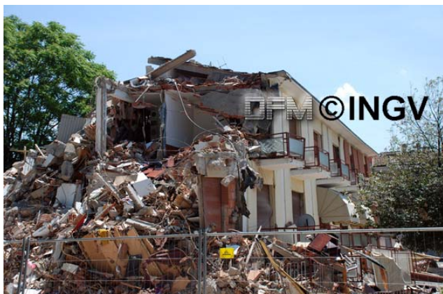
Foto 1. Cavezzo. Danno di grado 5 in edificio in C.A.
