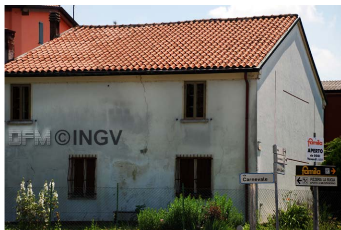
Foto 8. Poggio Rusco. Crepe diffuse in edificio di tipo B (danni di grado 2)
