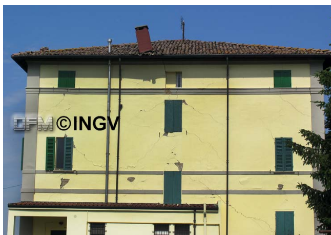
Foto 7. Alberone. Crepe diffuse e danni al camino in edificio di tipo B
