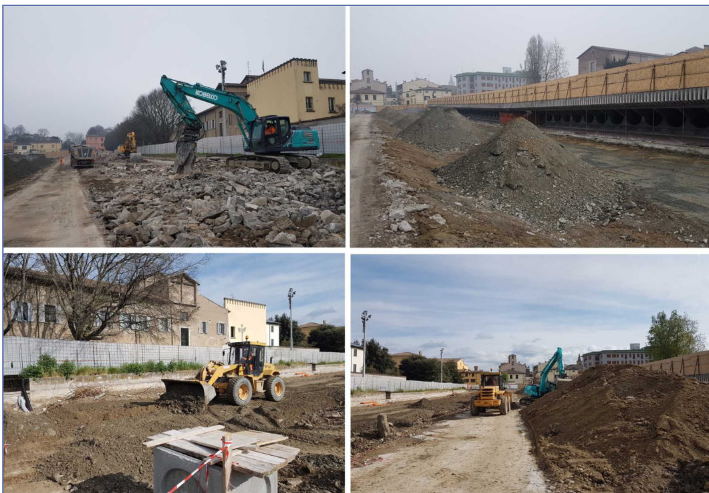
Figura 4. Forlì – Cantiere Giardino dei Musei, opere di demolizione e riporto del suolo 2021 (foto Comune di Forlì).
