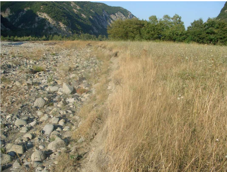
Figura 9 – Sponda in erosione in prossimità del Molino di Porcile
