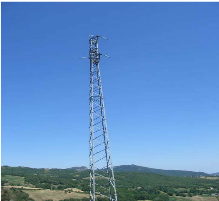
FIGURA 7 – TRALICCIO DI LINEA MT SUL VERSANTE EST DEL MONTE ERCOLE (ZONA TRA LOC. VILLA VERDE E LOC. LE MACCHIE)
