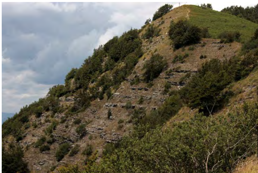
FIGURA 2.3.6.4-1 AFFIORAMENTI ARENACEI E MARNOSI COLONIZZATI DA BRACHYPODIETI XEROFILI NEI PRESSI DI UNA DELLE CIME SECONDARIE LUNGO IL CRINALE DEL MONTE CALVI
