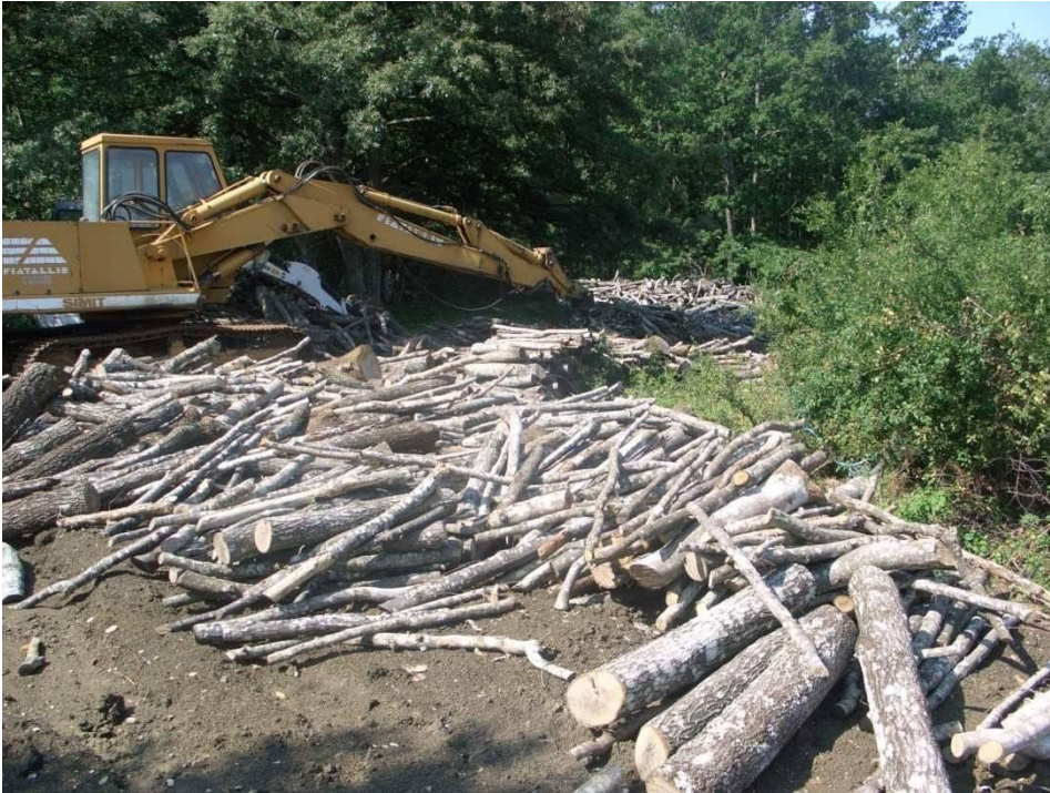
FIGURA 56 - IMPOSTO DI RACCOLTA E ACCATASTAMENTO LEGNA DA UTILIZZAZIONE DI BOSCO A PREVALENZA DI CERRO
