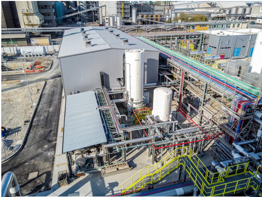
IMPIANTO DI RELIQUFEAZIONE
