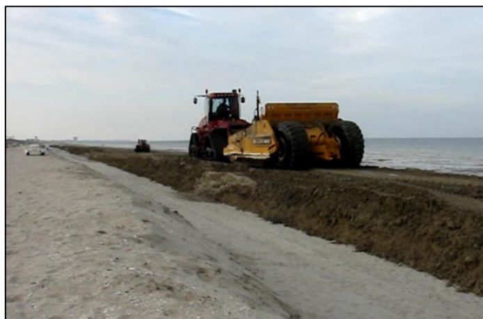
Figura I.4.2-17: Attività di prelievo di sabbia dagli accumuli litoranei della spiaggia sommersa e redistribuzione in quella emersa tramite scrapers
