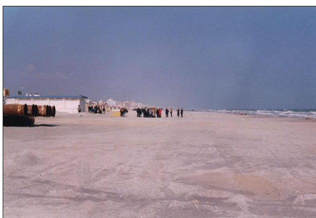
Figura I.4.2-4: Alcune operazioni condotte in fase di cantiere Progettone 1 e confronto situazione antecedente e successiva l'intervento a Riccione sud
