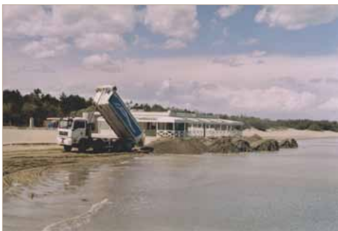
figura 25 il trasporto della sabbia tramite camion determina un forte impatto ambientale
