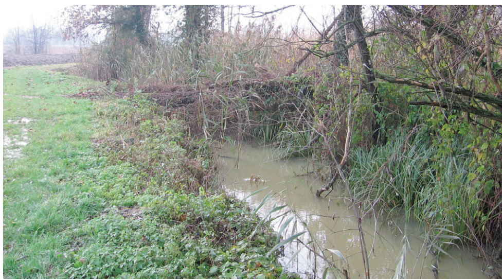
Figura 104 Problema di ostruzione di un canale causato dalla caduta di un albero in alveo. (Foto: Consorzio di bonifica Acque Risorgive)
