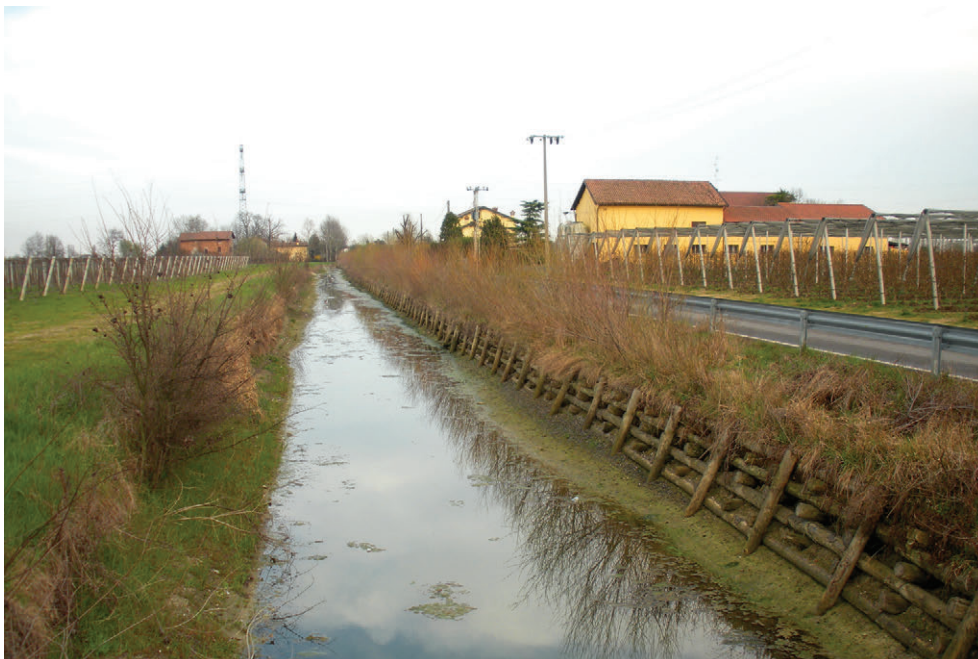
Figura 26 Aspetto di una palificata rinverdita nel periodo autunnale, dopo qualche anno dalla fine dei lavori: si noti lo sviluppo degli astoni di salice sulla sommità della palificata, a ridosso della strada. (Foto: Mario Fantesini)
