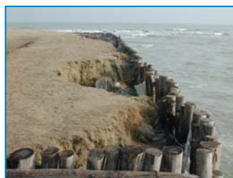
Erosione a tergo dei pali a seguito di un evento di mareggiata
