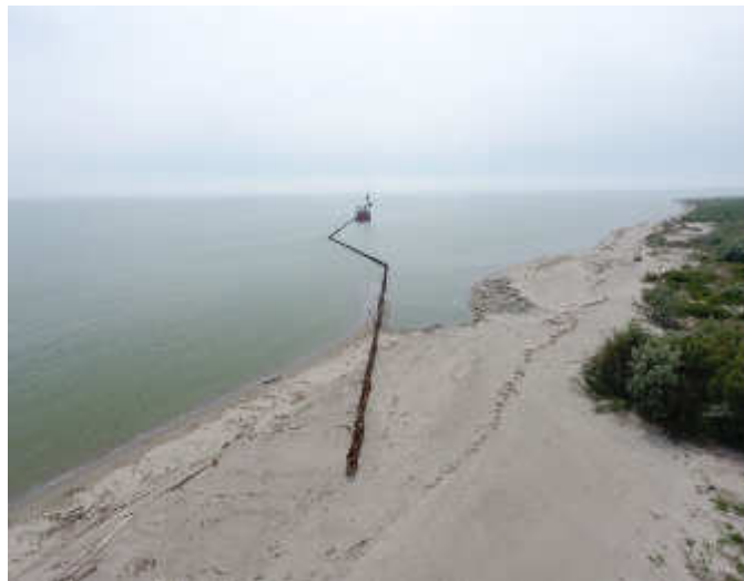
Fig. 8 - Viste da mare e da terra del pennello in pali di legno realizzato per orientare l'accrescimento dello Scanno
