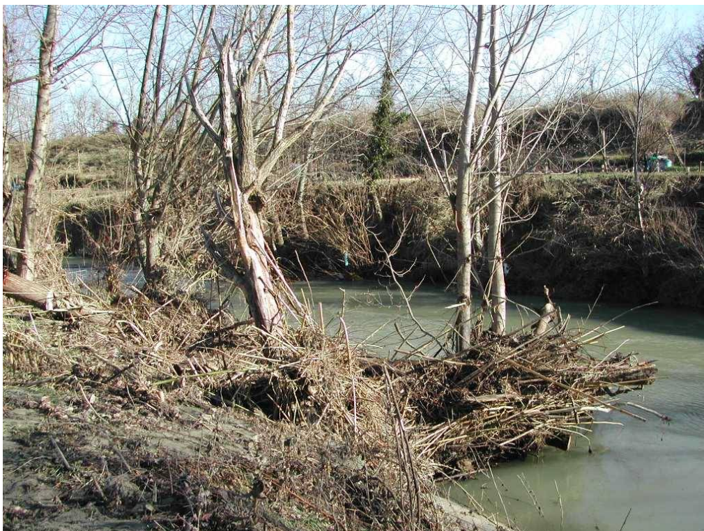
Fiume Lamone a valle abitato di Faenza Situazione tipologica di necessaria manutenzione
