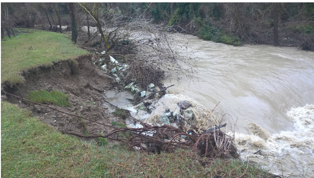
Torrente Marzeno. Esempio di necessaria manutenzione di briglia in pietrame
