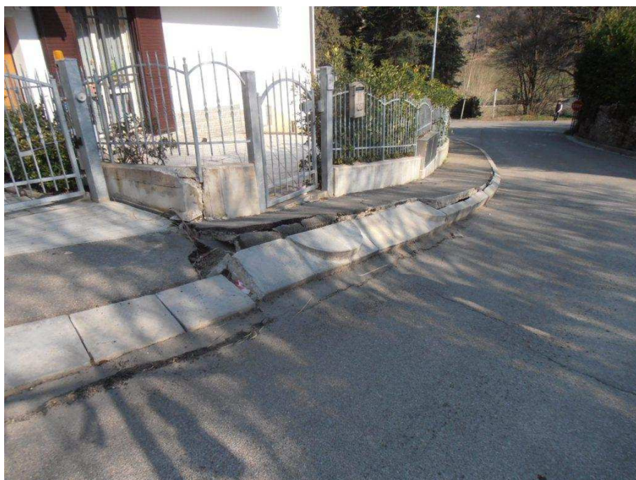
Foto 11 – Vista delle deformazioni e rotture del marciapiedi e del muretto perimetrale della recinzione del fabbricato residenziale posto in prossimità dell'incrocio tra Via dei Frati e la SP 20.
