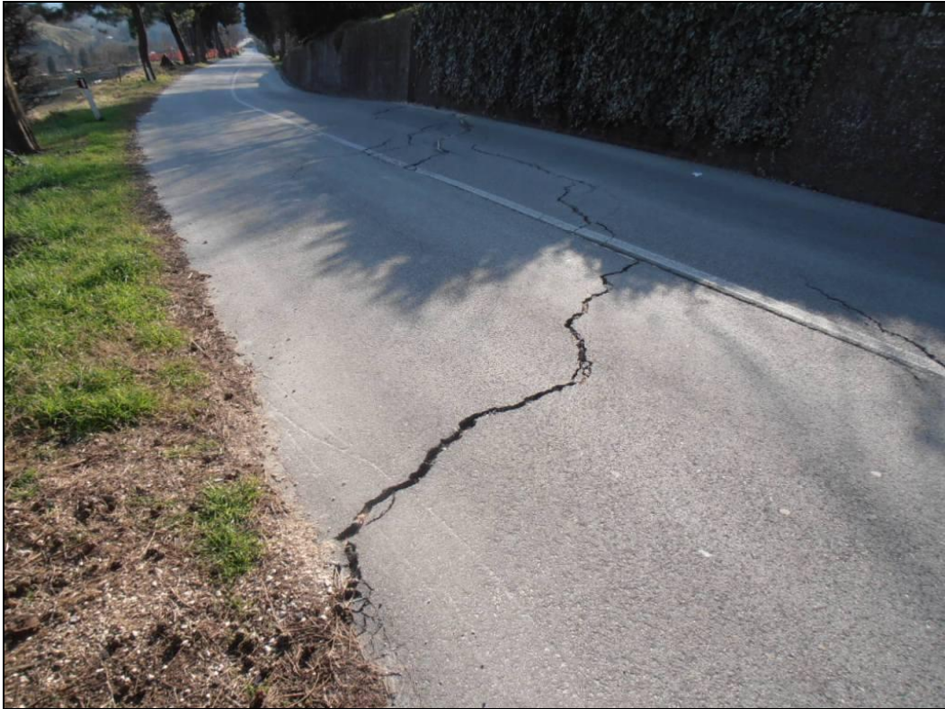
Lesioni sul manto stradale di fronte a casa Vico. Notare l'avvallamento del muro sulla destra.
