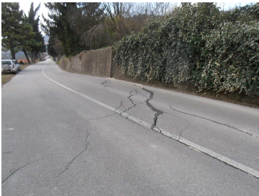
Foto 7 – Vista delle fratture della carreggiata della SP 20, in prossimità dell'incrocio con Via dei Frati.
