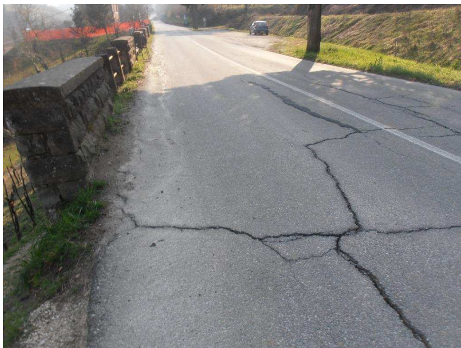
Foto 5 – Vista delle fratture della carreggiata della SP 20.
