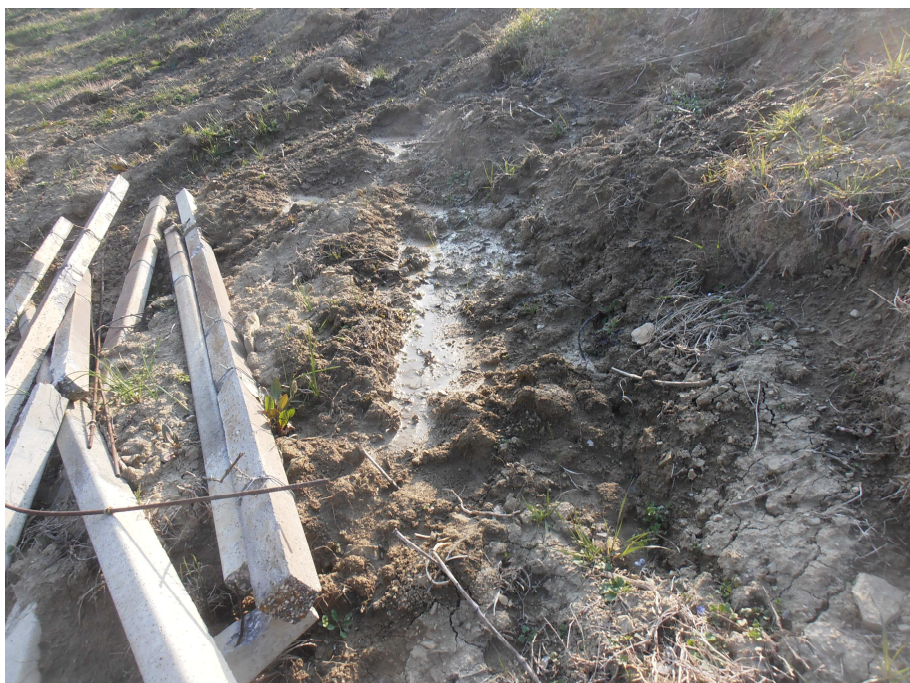
Foto 14 – Vista delle emergenze idriche rilevate al piede del versante in loc. Vico, a valle della SP 20.
