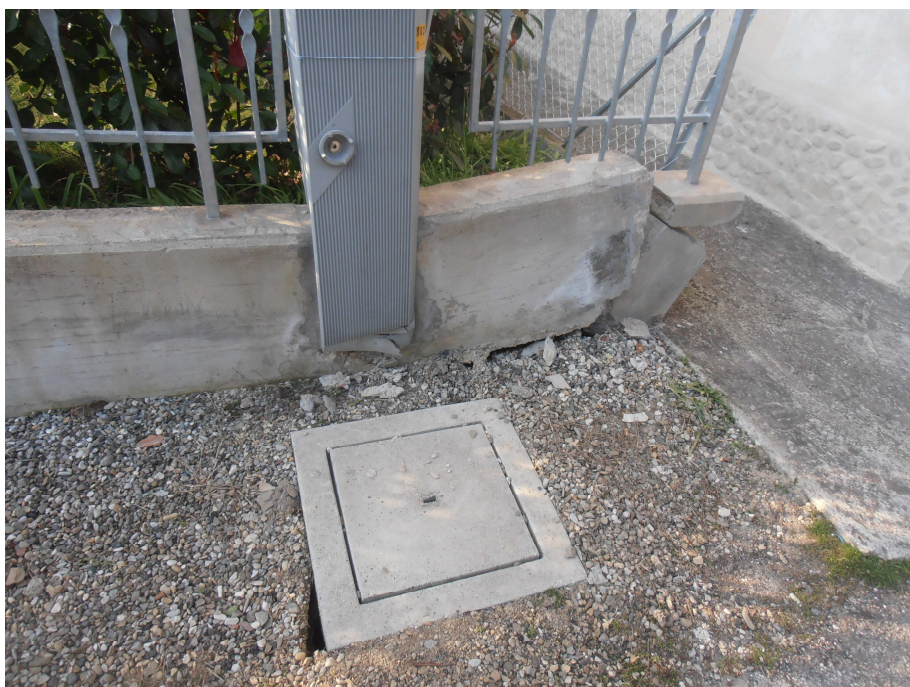
Foto 13 – Vista delle deformazioni e del muretto perimetrale prospiciente la SP 20, del fabbricato residenziale posto in prossimità dell'incrocio tra Via dei Frati e la SP 20 medesima.
