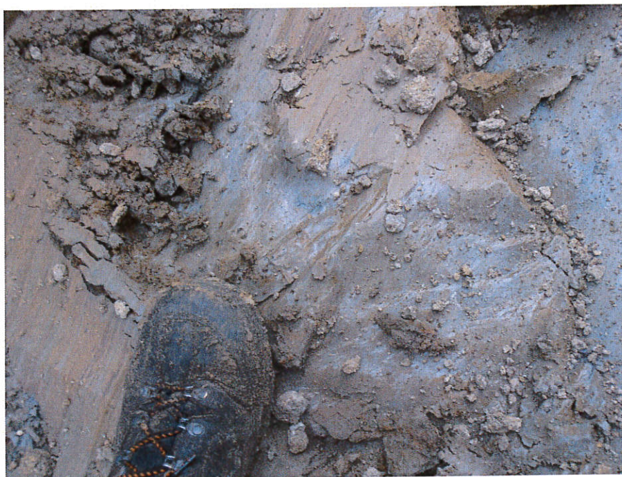
Foto 7 – Particolare di una superficie di scivolamento per frana riportata in affioramento sul fondo dello scavo obbligato dello scarico.
