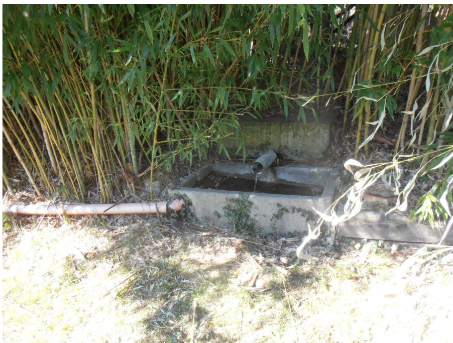
Foto 1 – Vista dello scarico del sistema di drenaggio realizzato dal Consorzio di Bonifica nel 1971. Si nota la scarsa portata idrica rilevata in data 06/03/2015.
