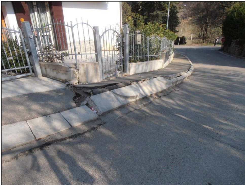
Lesioni sulla recinzione dell'edificio posto sul fianco sinistro della frana
