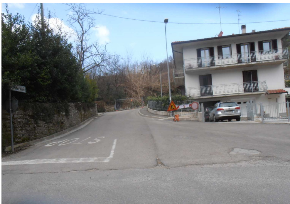
Foto 10 – Vista del fabbricato residenziale coinvolto nel dissesto franoso, posto in prossimità dell'incrocio tra Via dei Frati e la SP 20.
