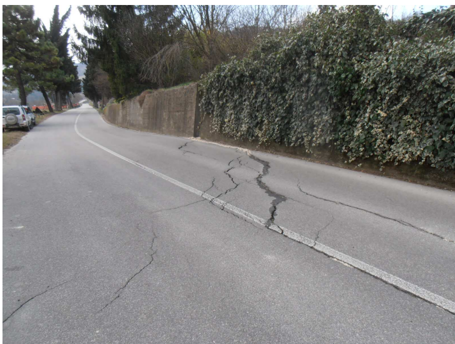
Foto 8 – Vista in data 06/03/2015 delle fratture e della deformazione altimetrica della carreggiata della SP 20, in corrispondenza del fabbricato residenziale Vico, che si trova immediatamente a monte del muro di contenimento.
