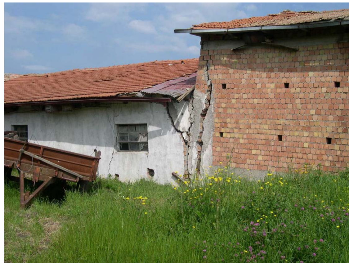
Fig. 3 – Lesioni negli edifici (Mari, 2005)
