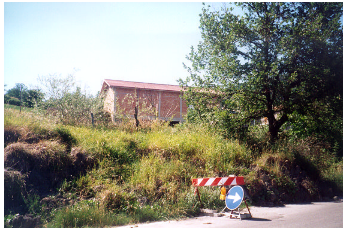
Foto 2: strada provinciale coinvolta ed edificio minacciato al piede della frana
