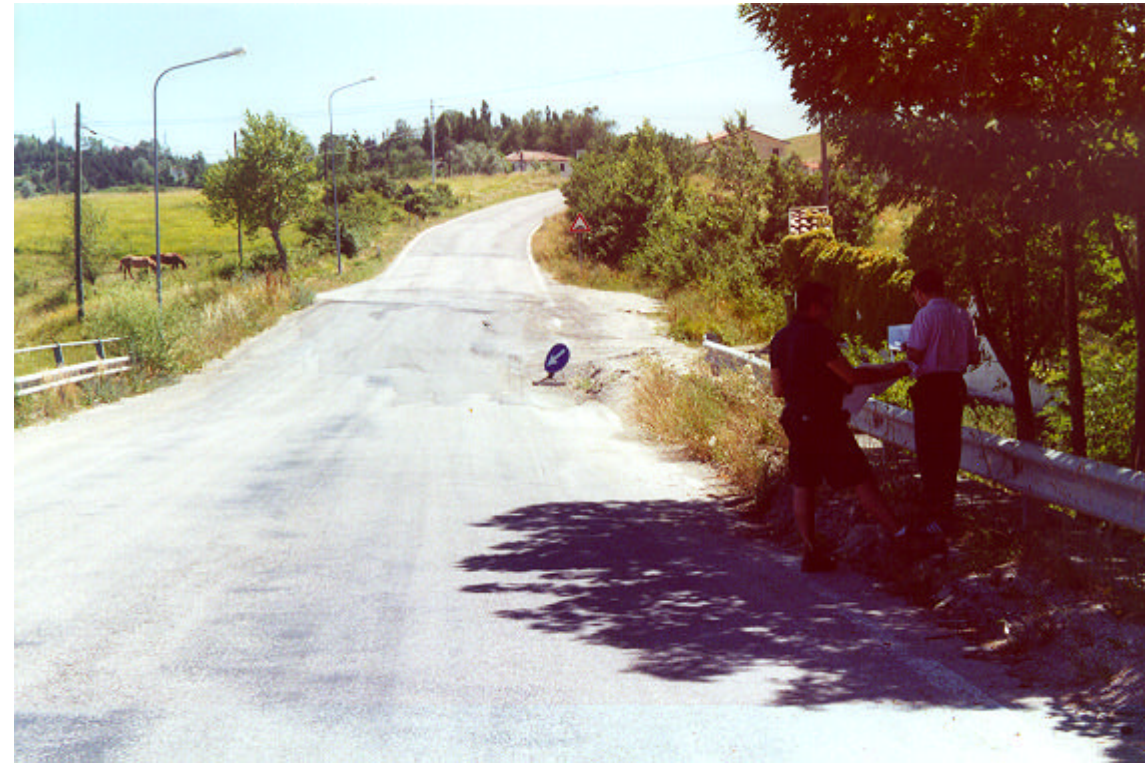
Foto 1: tratto della strada provinciale coinvolta nel coronamento della frana
