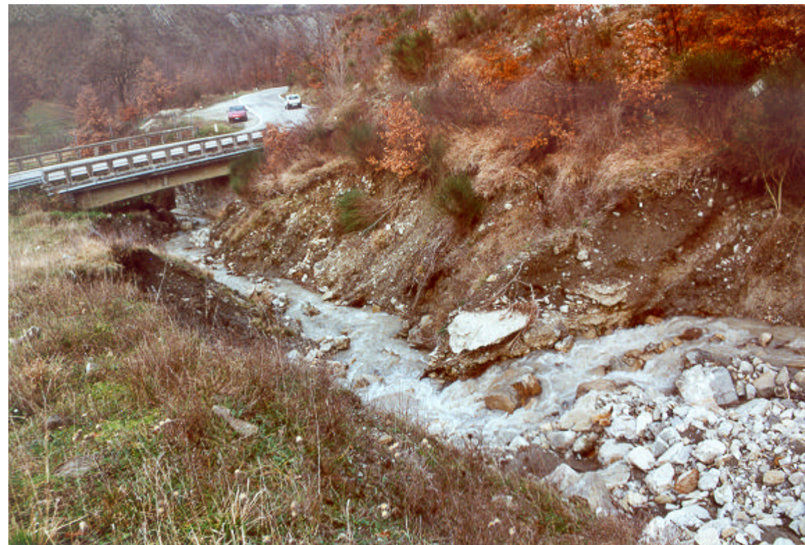
Foto 1: corso d'acqua in forte erosione ad est di Schigno
