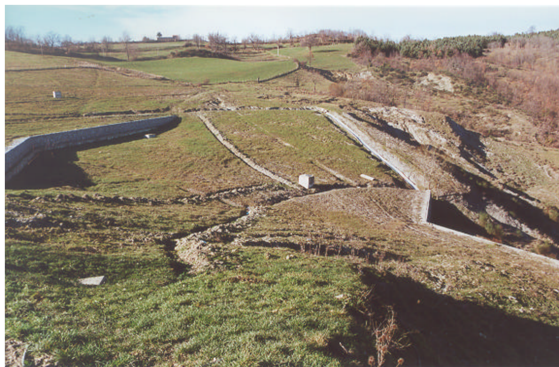
Foto 2: bacino del fosso della Rocca in forte erosione, opere di regimazione e contenimento insufficienti, subito a valle dell'abitato
