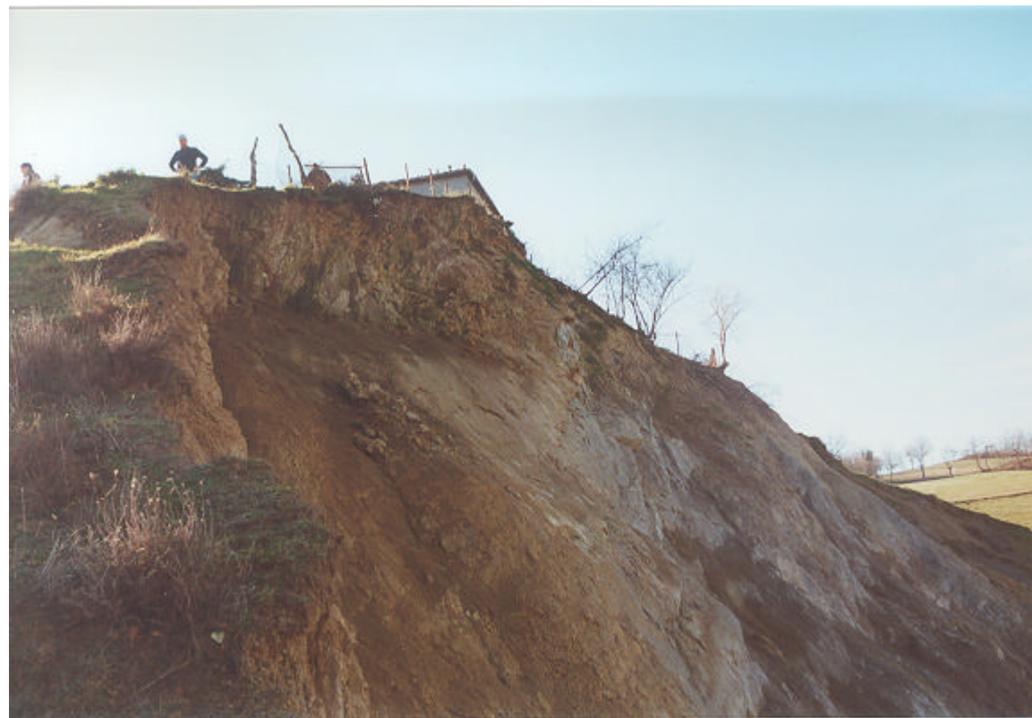
Foto 1: crolli e scivolamenti che minacciano direttamente alcuni edifici
