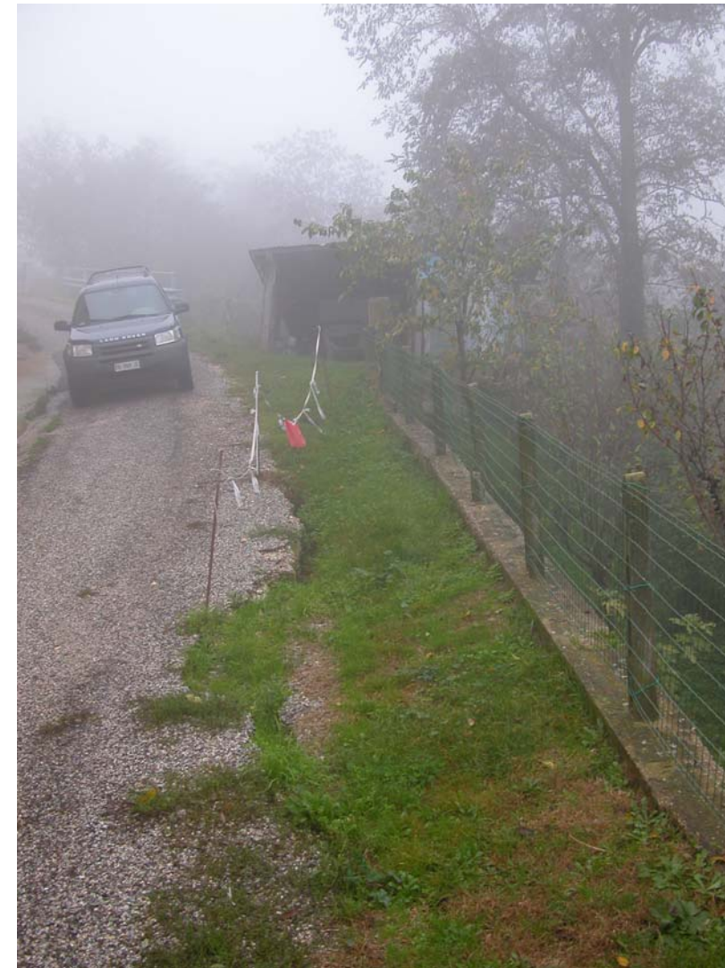
Fig. 3 – Lesioni presenti lungo la viabilità (Fabbri, 2005)
