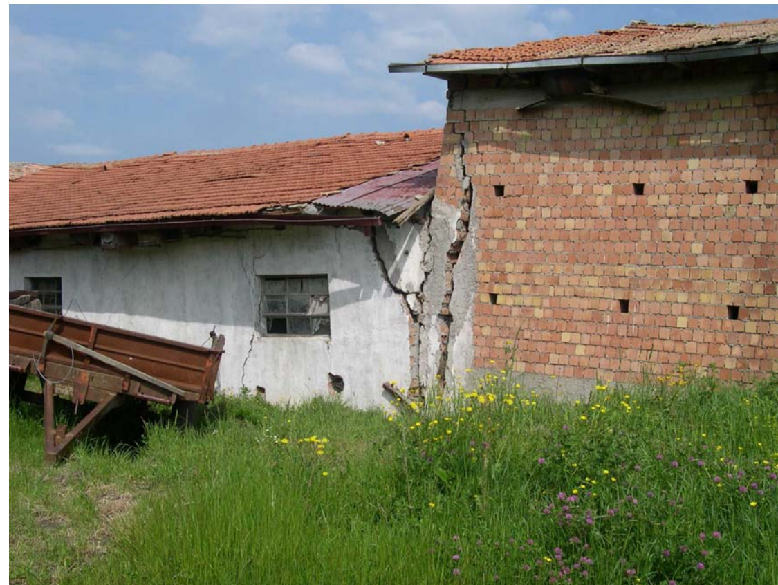
Fig. 3 – Lesioni negli edifici (Mari, 2005)
