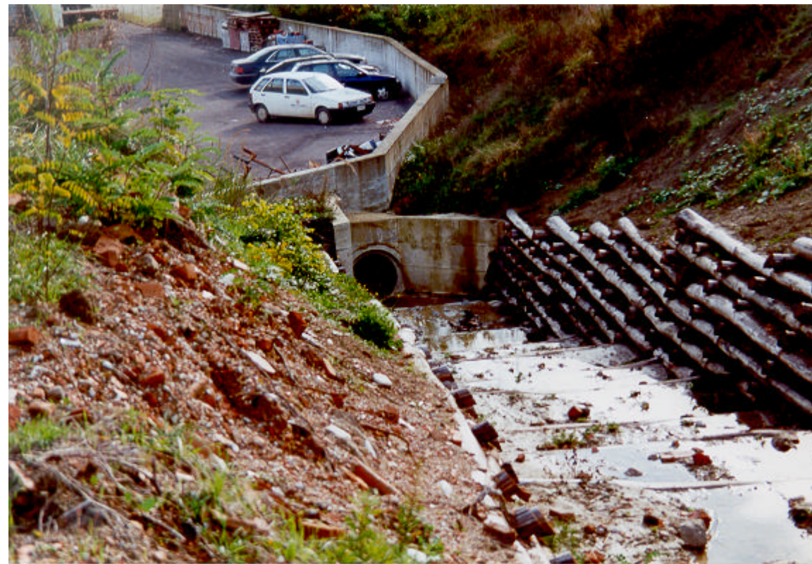
Foto 2: interventi in fase di realizzazione a monte del tratto intubato del Fosso Spessie
