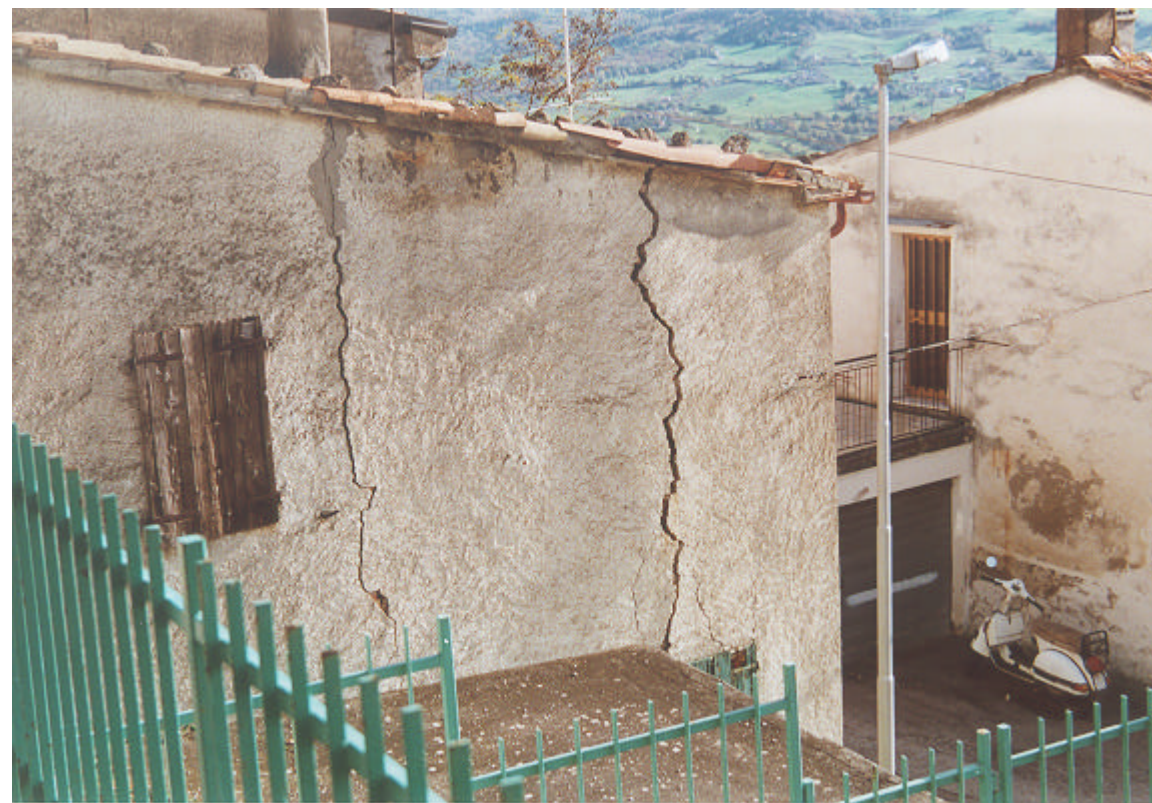
Foto 1: edifici lesionati a valle della strada provinciale
