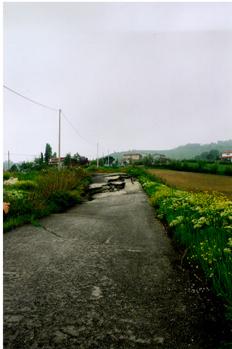
Foto 1: particolare del dissesto che coinvolge Via Franzolini, sulla destra idrografica del Rio Morgona
