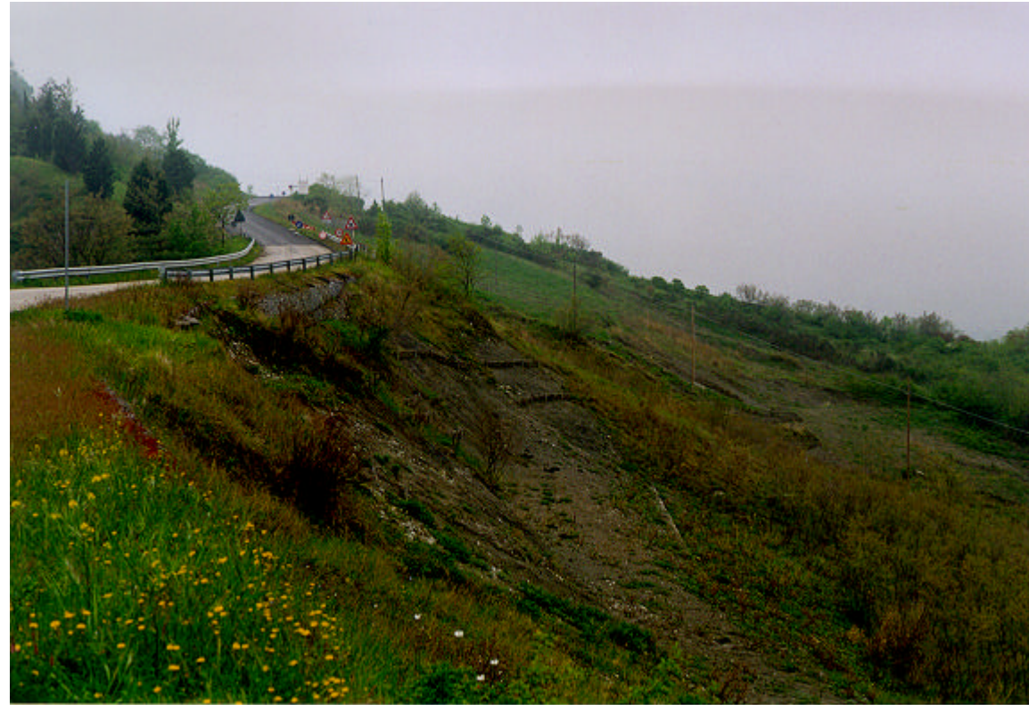
Foto 1: particolare del dissesto che minaccia in regressione la S.P. 120
