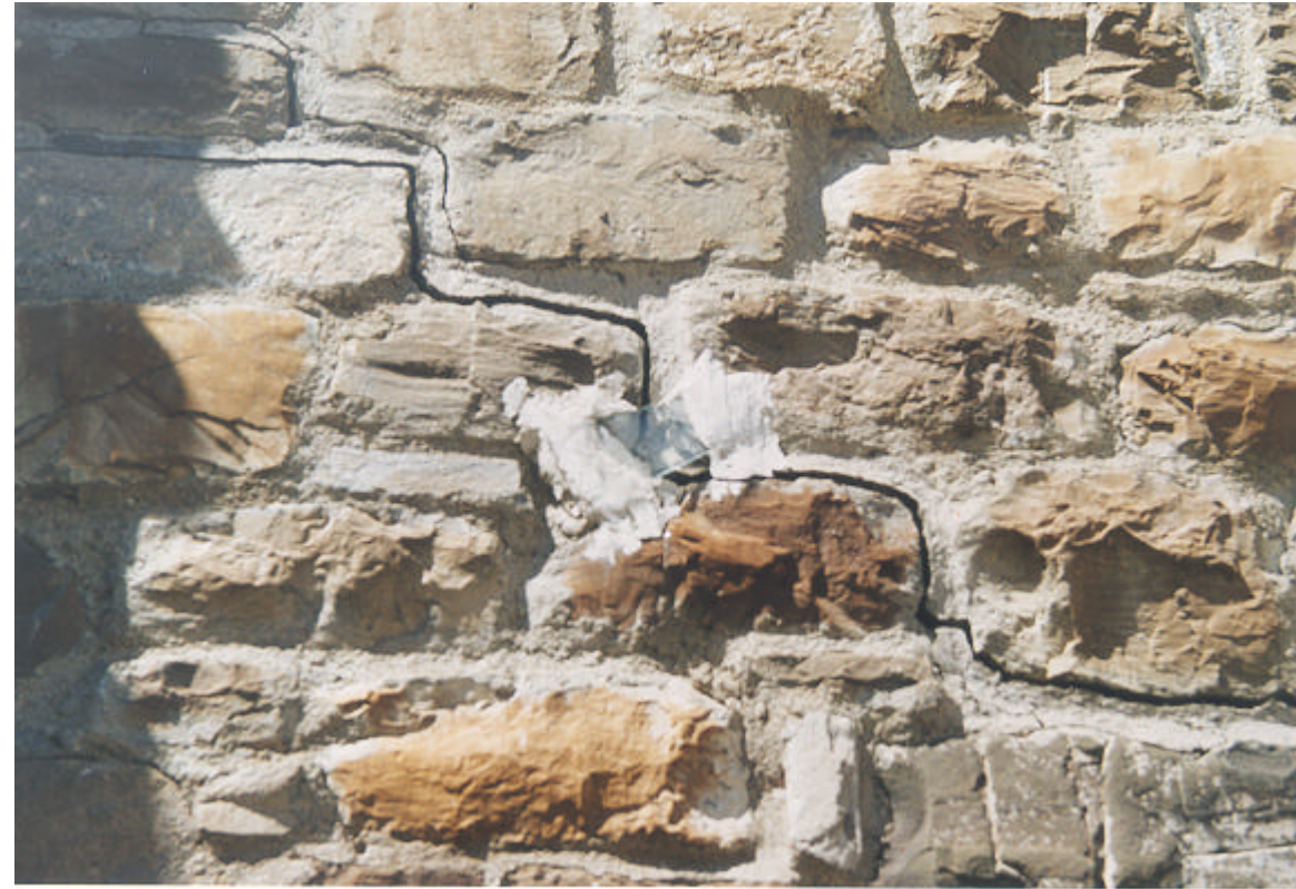
Foto 1: edifici lesionati presso il centro storico e strumenti di monitoraggio del quadro fessurativo
