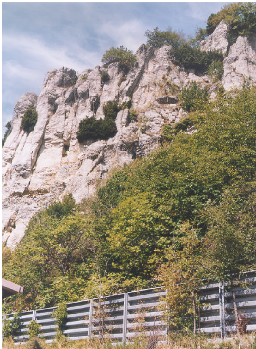
Foto 1: parete soggetta a crolli e barriere paramassi realizzate subito a monte dell'abitato
