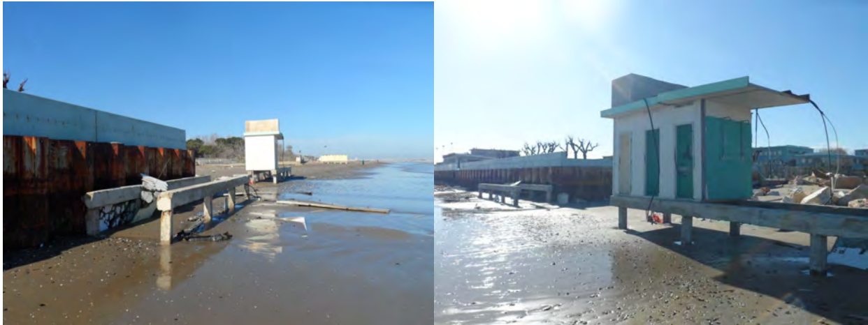
Figura 34. Foto che testimoniano l'erosione della spiaggia, che ha messo a nudo le fondazioni delle infrastrutture turistiche presenti sulla spiaggia.
