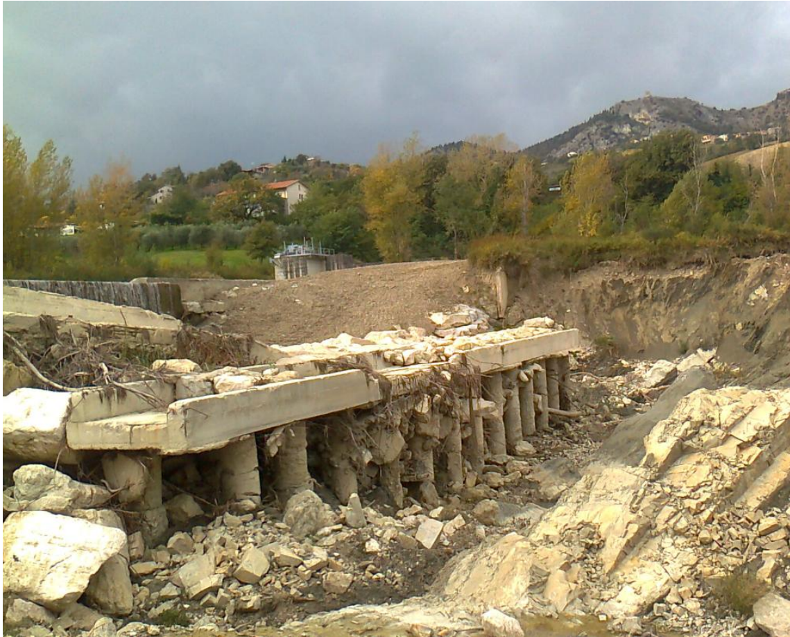
Marecchia. Dissesto della controbriglia della traversa di derivazione di Ponte Verucchio
