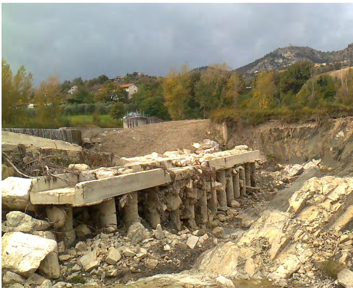
Figura 34 - F. Marecchia. Dissesto della controbriglia della traversa di derivazione di Ponte Verucchio
